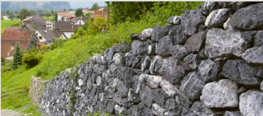
In Wartau SG legt ein Konzept die Prioritäten für die Sanierung der vielen Trockenmauern fest.
