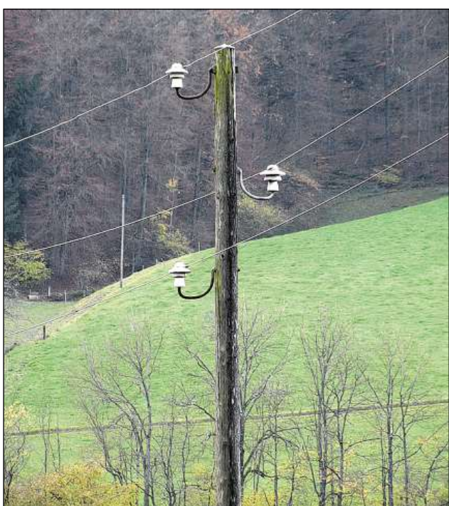
Pir il 1968 è Furna ed il 1972 S. Martin vegnids colliads a la rait d'electricitad.
