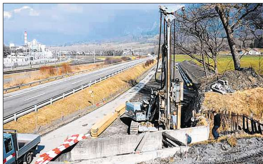
Construcziun da la rait da chalur a distanza tranter Trimmis e Cuira.
