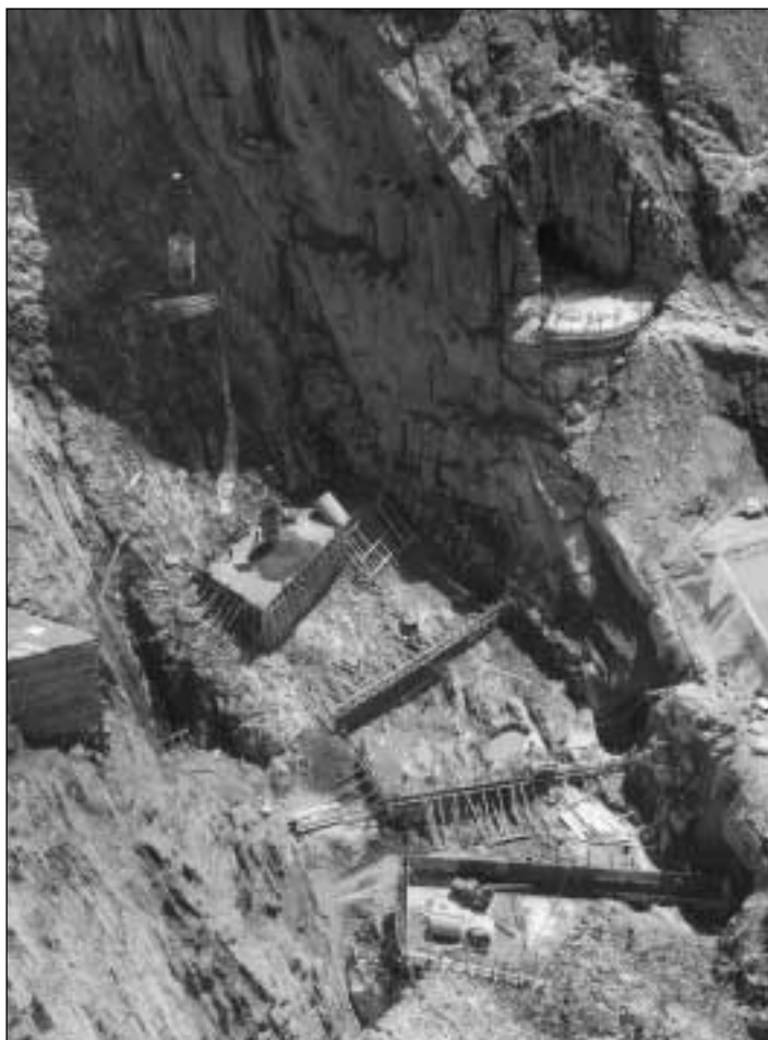
Sguard sin ils fundaments a l'entschatta da la construcziun dal mir da fermada dal lag a Curnera.
